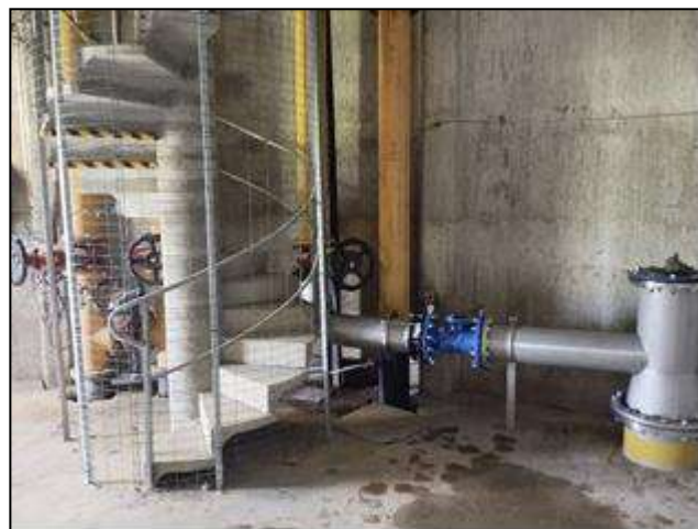
4 - Raccordement 400 fonte réservoir Pécorade
