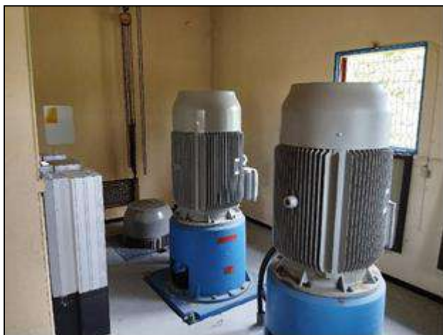
3 - Station Pécorade, changement moteurs + installation variateurs
