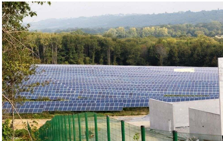
Figure 22 : Parc solaire de Sévignacq
